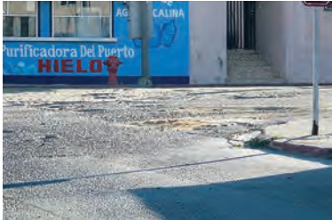
Las calles del Costa Bella están en estado deplorable.
